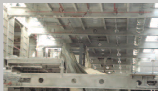
Mise en place du flocage Grace Monokote ® MK-6 sur la charpente métallique.
